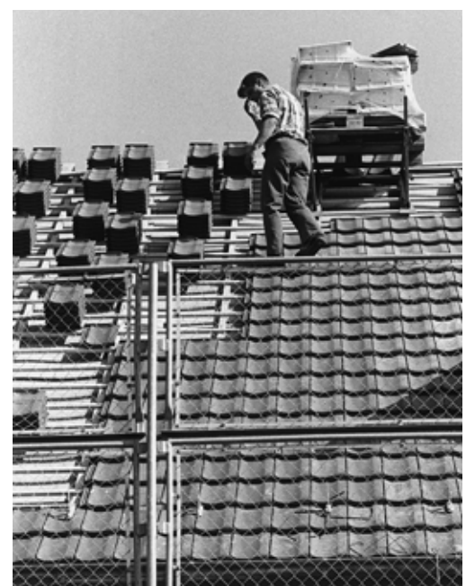
Bild 6: An Schrägdächern bietet eine Dachdeckerschutzwand mit Gittern einen idealen Schutz vor Absturz von Personen, Gegenständen und Materialien.
