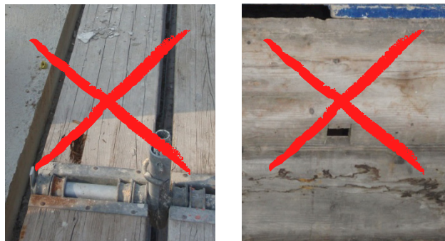
Bilder 2 und 3 Gerissene und angesägte Beläge müssen ausgetauscht werden.
