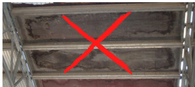
Bild 1 Grosse schwarze Flecken weisen darauf hin, dass der Belag möglicherweise angefault ist. Der Belag muss kontrolliert werden.
